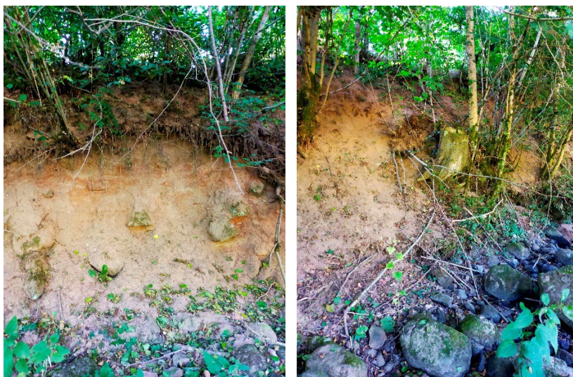
Photographies du talus lors de la visite de site le 10/08/2022
